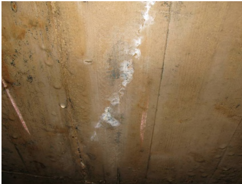
Foto 22 Kalkuitbloeiingen ter plaatse van scheurvorming in een dek.
