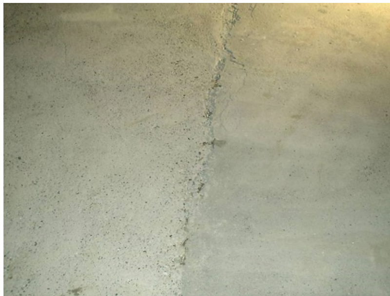
Foto 23 Onvlakheid ter plaatse van aangeheelde vloer.
