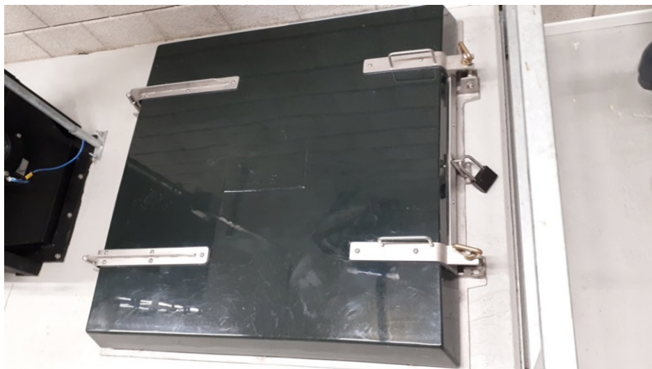
Foto 4 Volledig afsluitbaar RVS toegangsluik (foto Evides Waterbedrijf).
