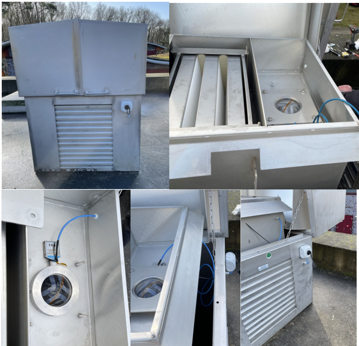
Foto 18 Een beluchtungsfilter met een secundaire (anti-inbraak)schil, met daarbinnen het filter en de bypass voorzien van een breekplaat met een koperdraad (de koperdraad is uitbedraad naar een meetkastje aan de buitenkant van de buitenschil, die het mogelijk maakt de eventuele breuk met een multimeter door te meten) (foto's PWN).
