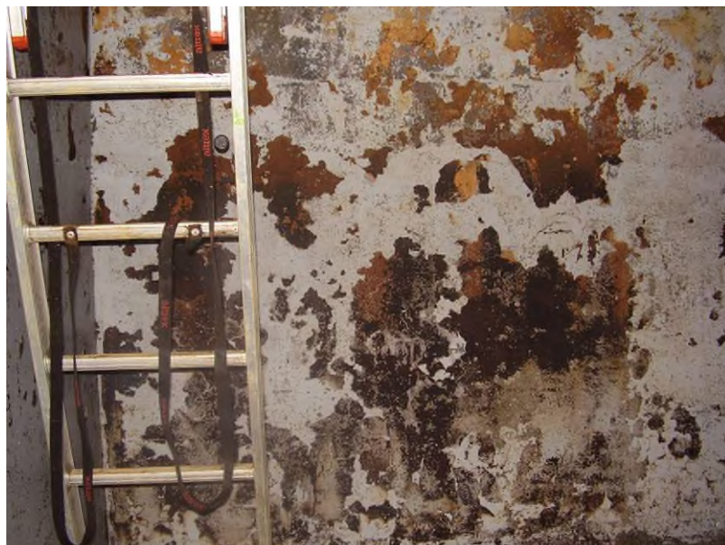
Foto 27 Beschadigde coating op wandconstructie als gevolg van erosie.
