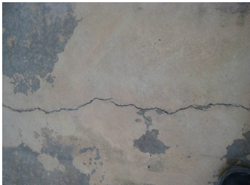
Foto 19 Scheurvorming in wandconstructie.
