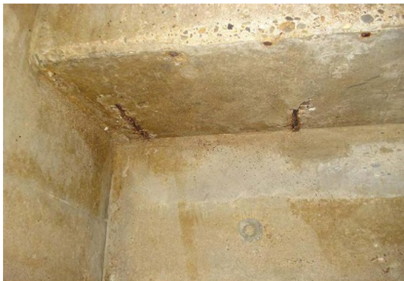
Foto 21 Plaatselijk corroderende wapening als gevolg van onvoldoende betondekking.
