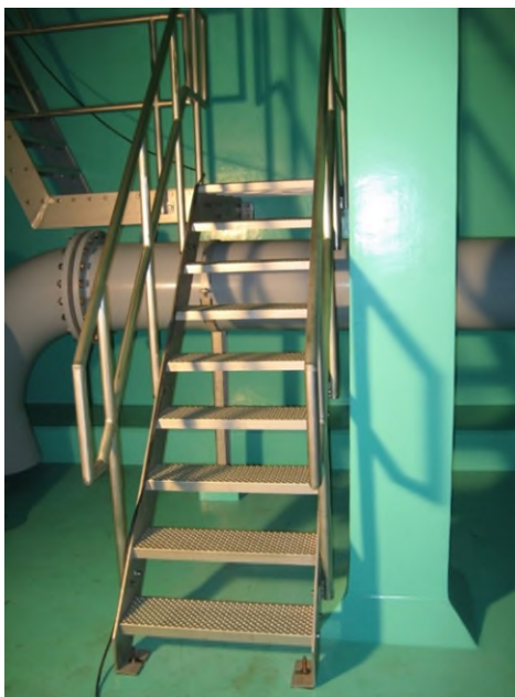
Foto 5 Roestvaststalen trap in een reservoir (foto Vitens) 22 .
