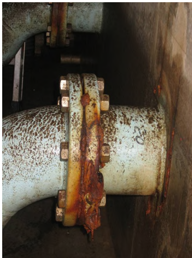
Foto 29 Corrosie van ingestort muurdoorvoerstuk.
