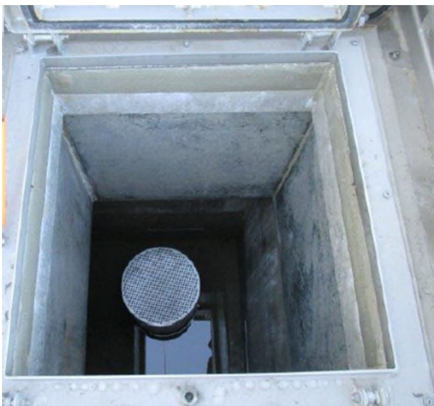
Foto 11 Betonnen overstortconstructie in een kelder met extra inkruipbeveiliging (ratten en ander ongedierte). Het luik is voorzien van een slot (foto PWN).
