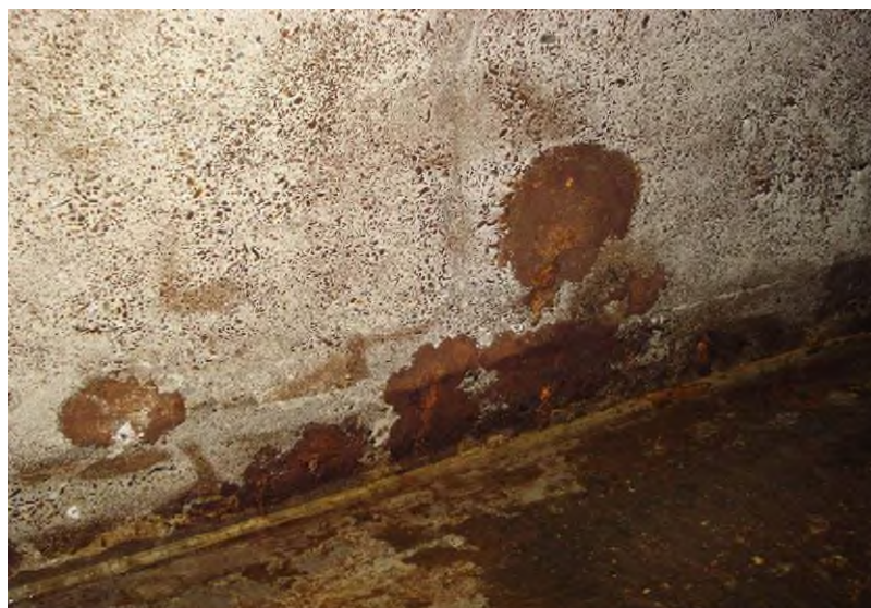
Foto 25 Biofilmvorming ter plaatse van vloer-wand aansluiting.
