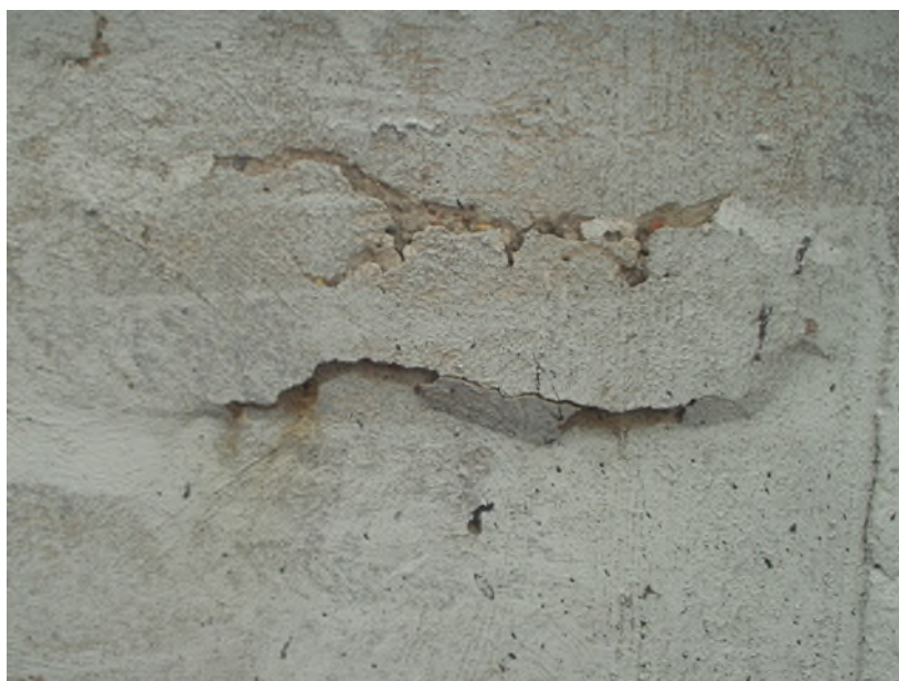
Foto 20 Afgedrukte betondekking (scholvorming) als gevolg van corrosie door onvoldoende betondekking.
