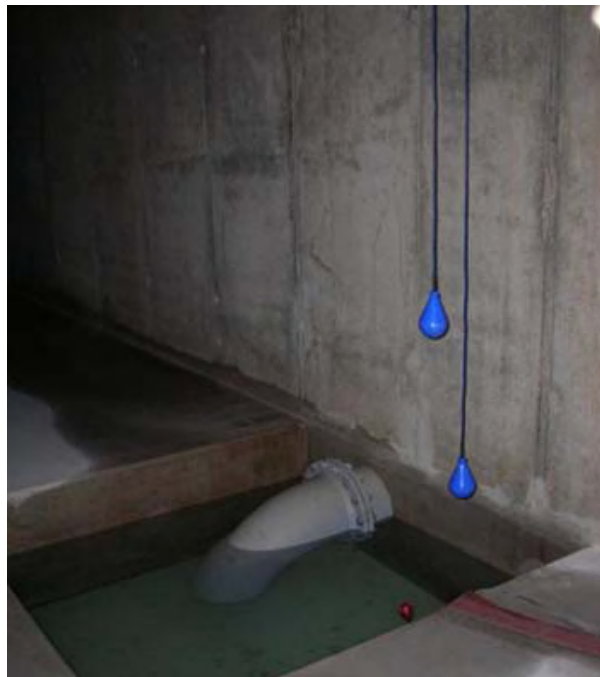
Foto 6 Zuigkuil met niveaumetingen (foto Vitens).
