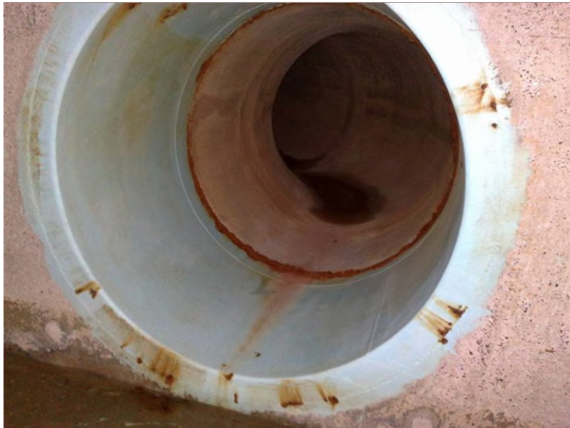
Foto 28 Beschadigde coating en corrosie aan ingestorte stalen doorvoer.
